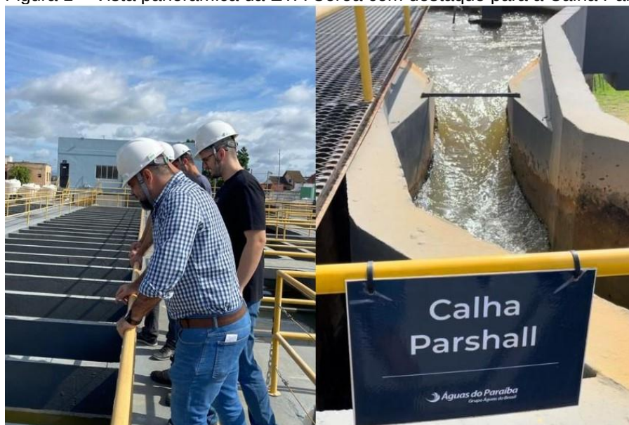
Figura 1 – Vista panorâmica da ETA Coroa com destaque para a Calha Parshall
