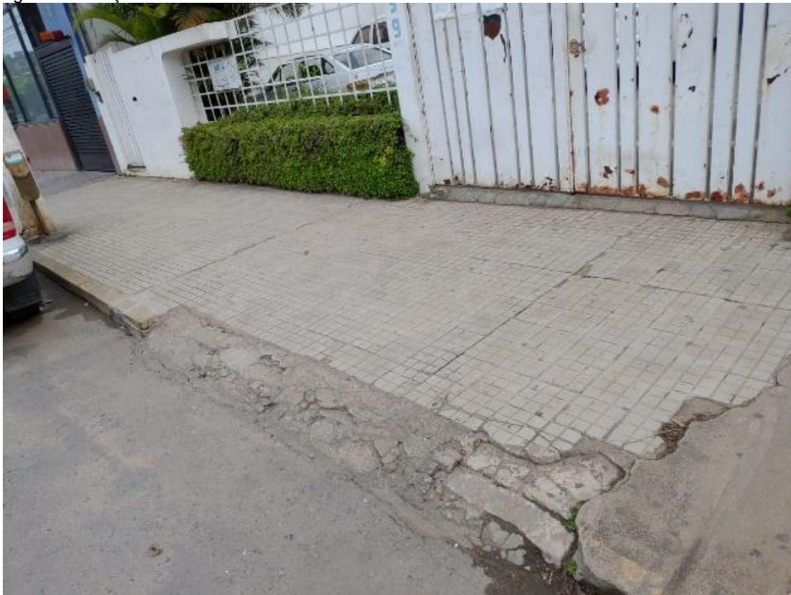
Figura 7 - Calçada em um dos trechos da avenida da avenida Cardoso Moreira.
