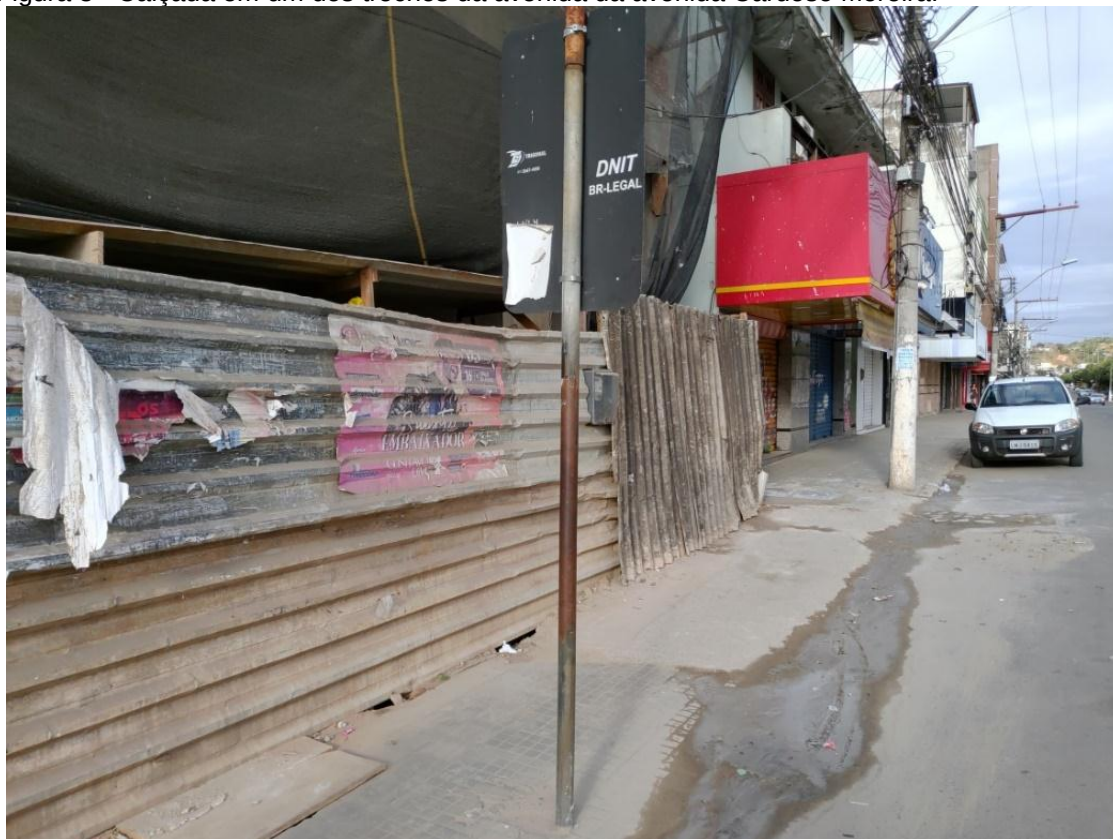
Figura 8 - Calçada em um dos trechos da avenida da avenida Cardoso Moreira.
