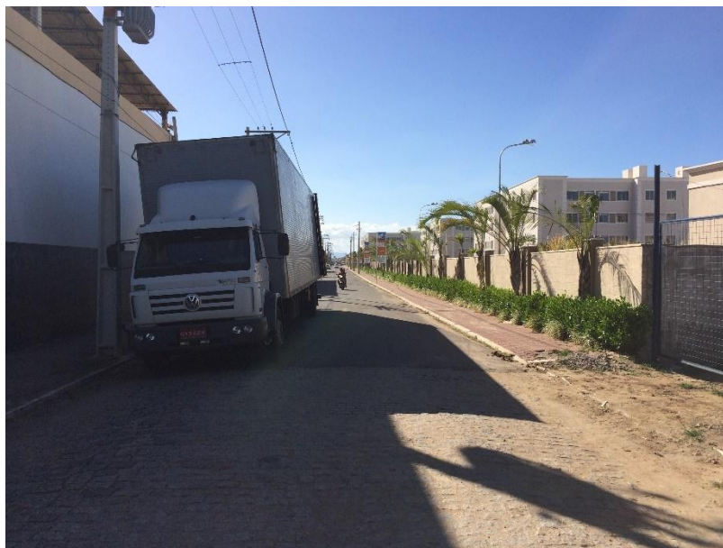
Figura 56 - Interrupção do asfalto juntamente ao limite do condomínio da MRV. Fonte: Acervo Pessoal, 2017.
