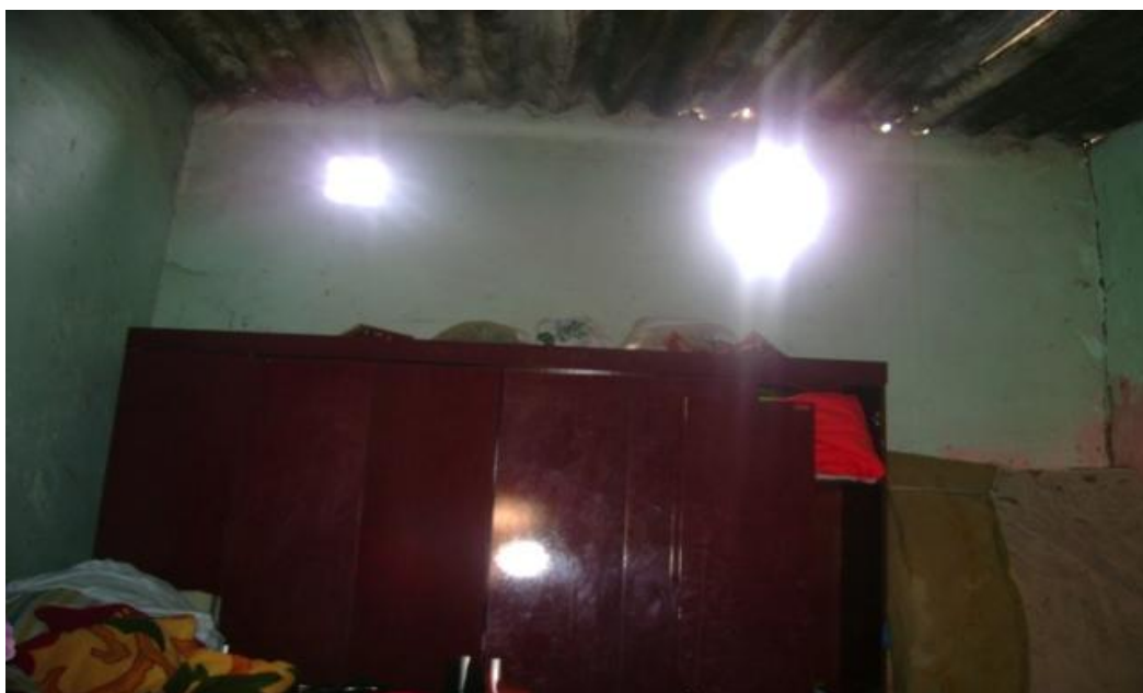
As únicas entradas de ventilação desse dormitório eram estes 2 orifícios na parte superior da parede
