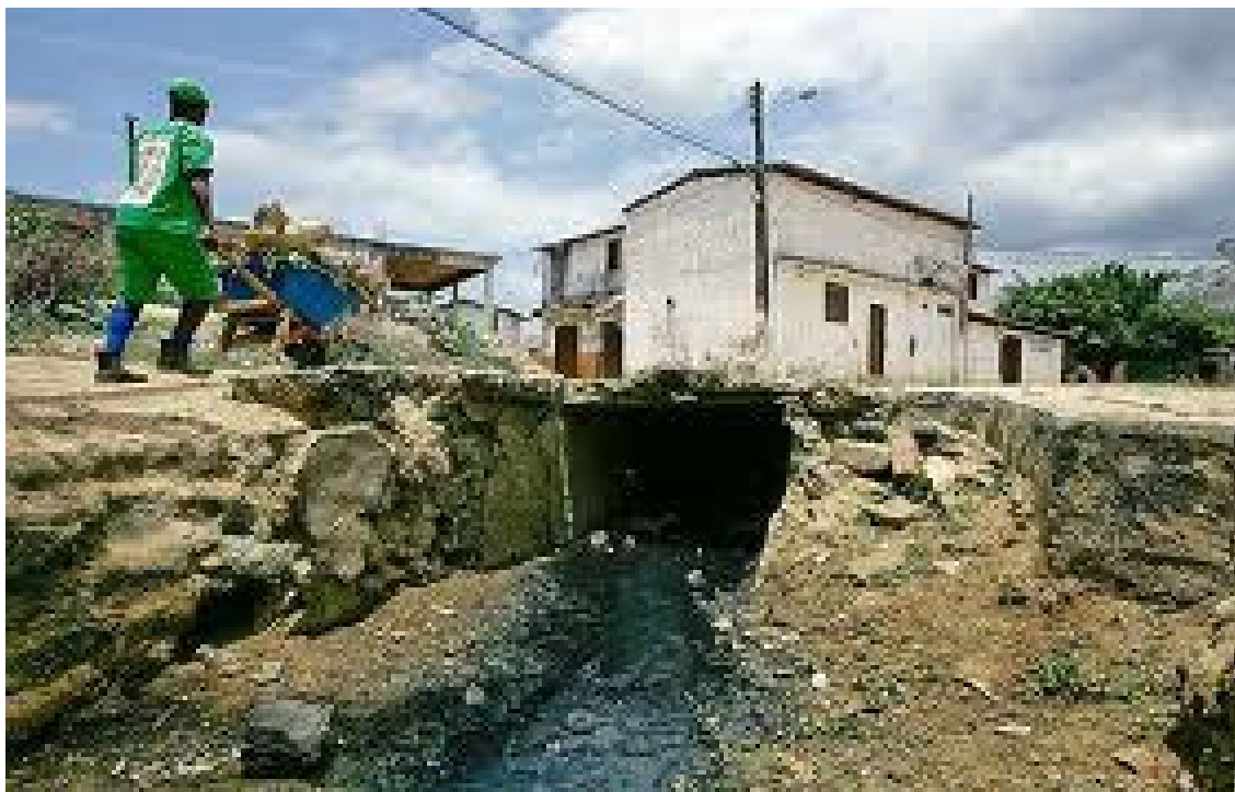
Esgoto a céu aberto – Macaé-RJ - 2012
